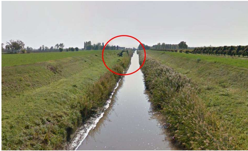
Figura 31 - Necessità di poter continuare ad eseguire la manutenzione dell'alveo
