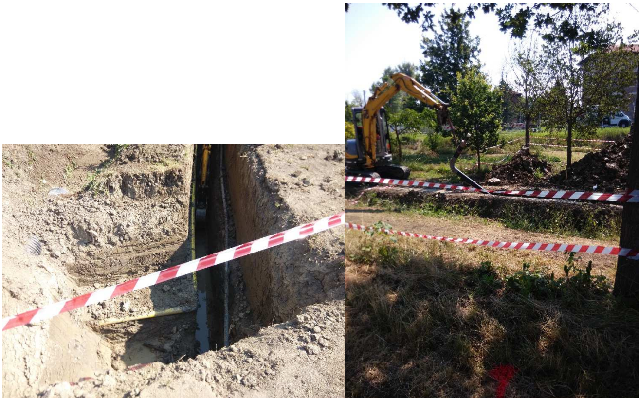
Figura 83 – Nella foto di sinistra si nota la tubazione del gas che deve essere portata a maggiore profondità, all'interno dello scavo appositamente predisposto a fianco. Nella foto di destra si nota il raccordo ad U della tubazione del gas che è stato posato per approfondire la tubazione del gas.
