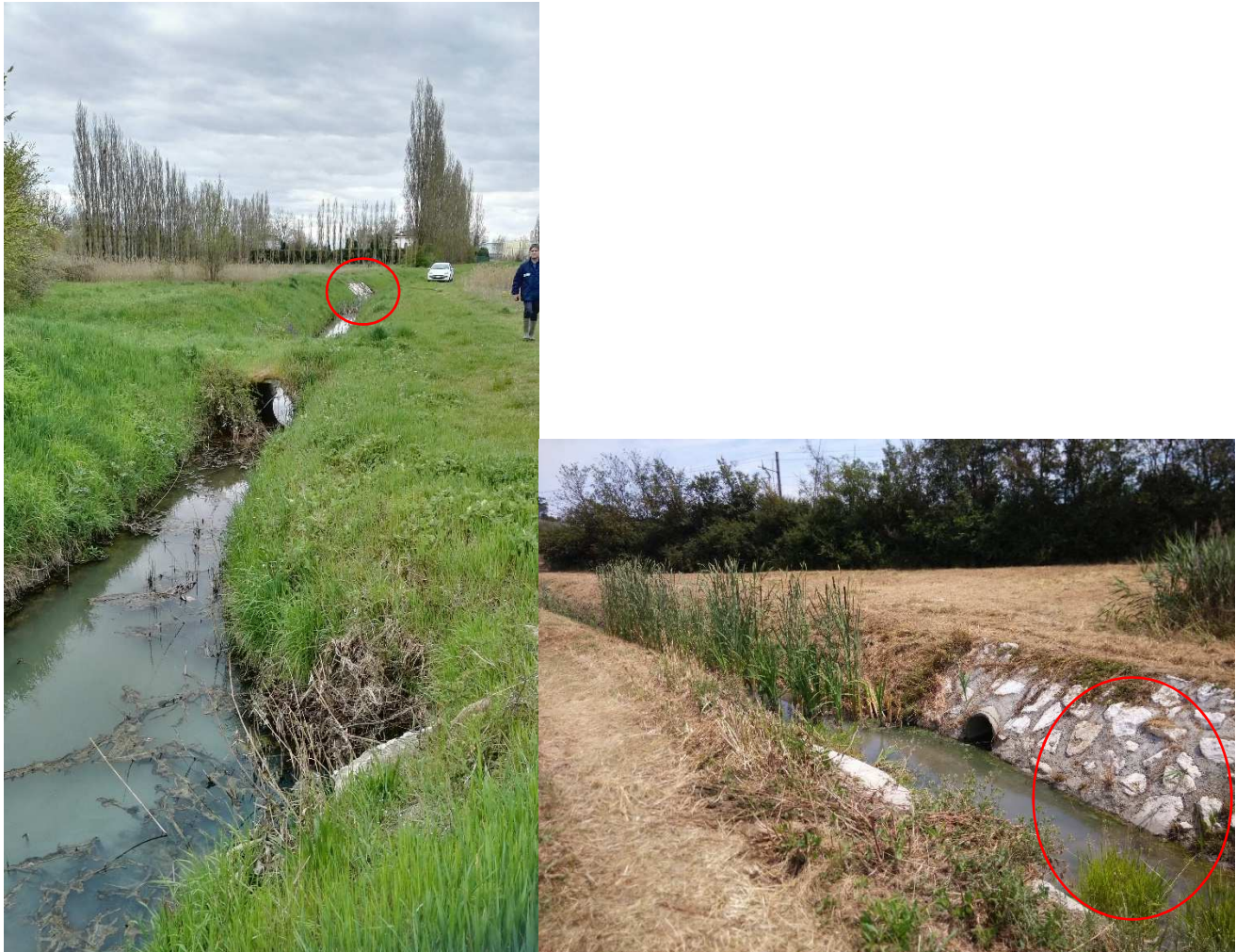
Figura 84 – Nelle foto si nota la protezione spondale e del fondo presente in corrispondenza del sottopasso della tubazione dell'acqua potabile lungo la Cavata Orientale.
